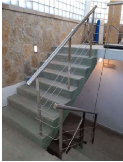
Estat inicial barana escala amb mancances en PRL.
