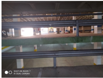
Estat inicial biondes amb mancances en PRL.
