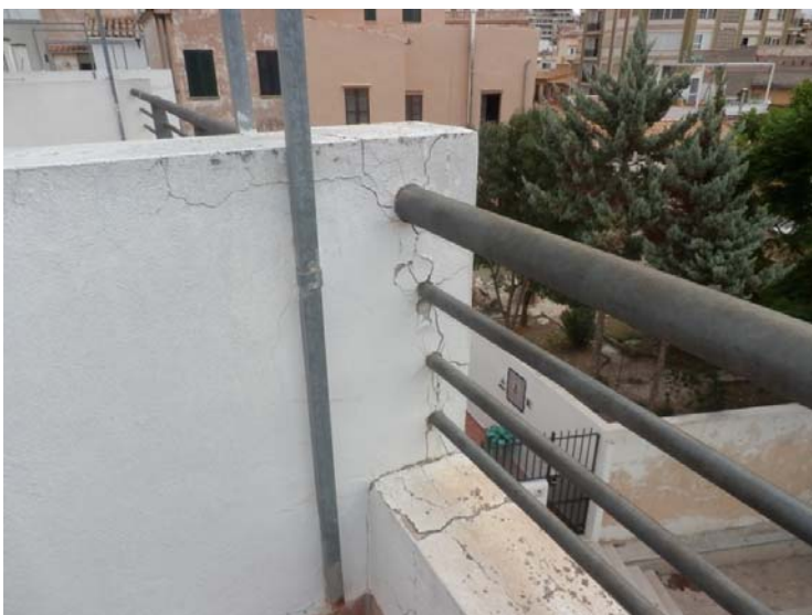
Patologia d'encontre de la barana
