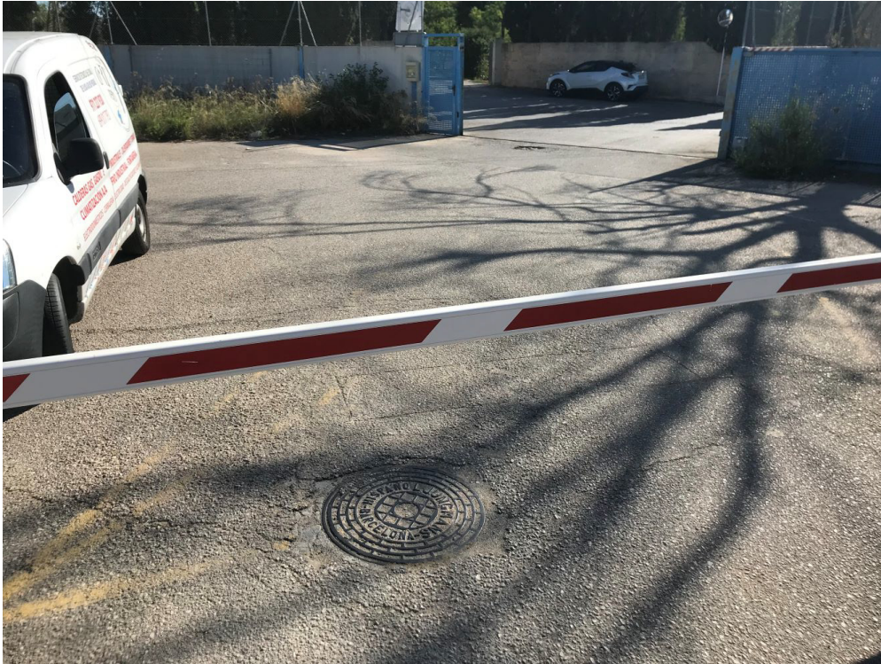
Fotografia 3. Ubicació de la tapa d'accés a la boca de càrrega del dipòsit 1
