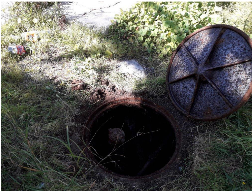
Fotografia 1. Ubicació de la tapa d'accés a la boca de càrrega del dipòsit 1
