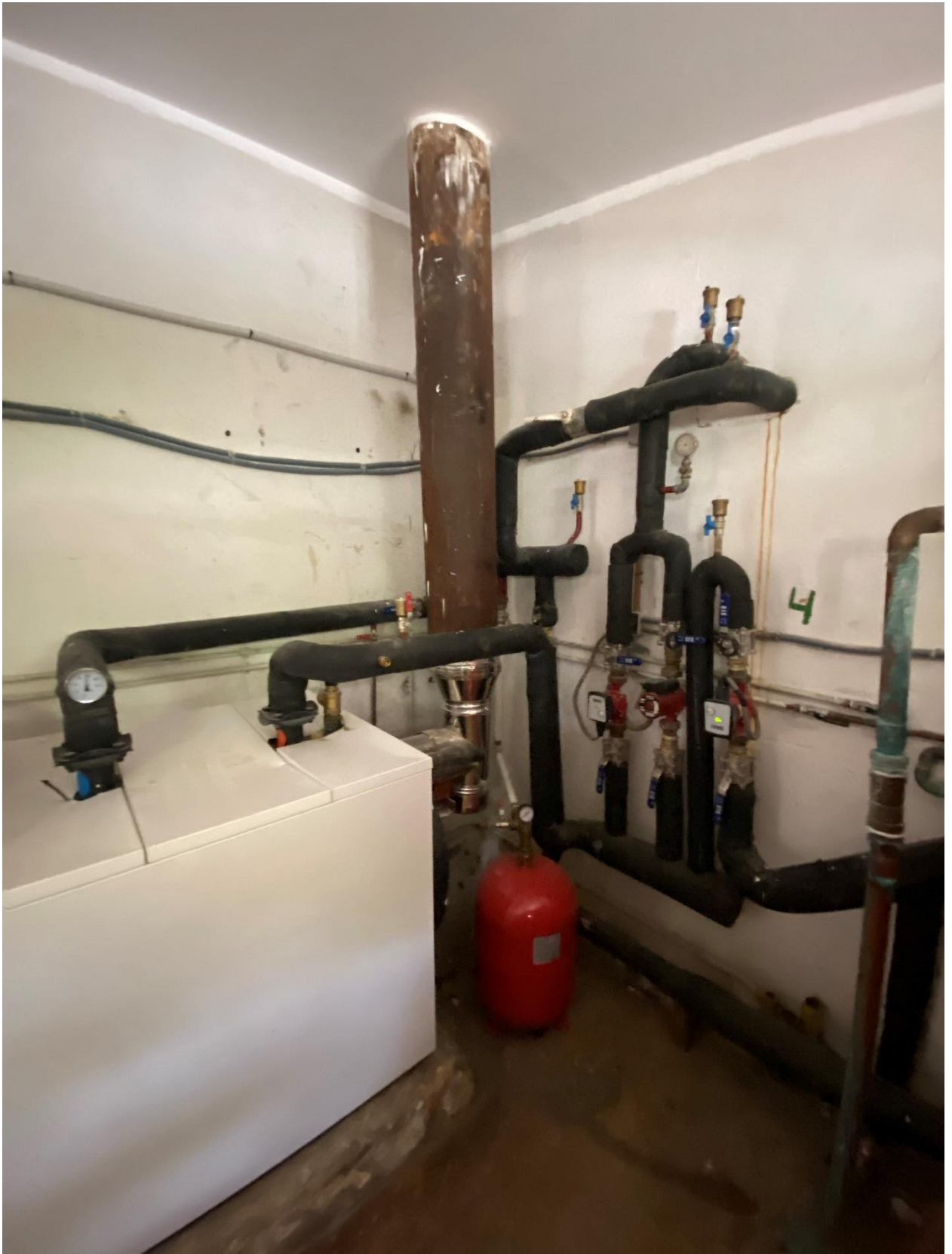
Detalle 2 Sala de máquinas
