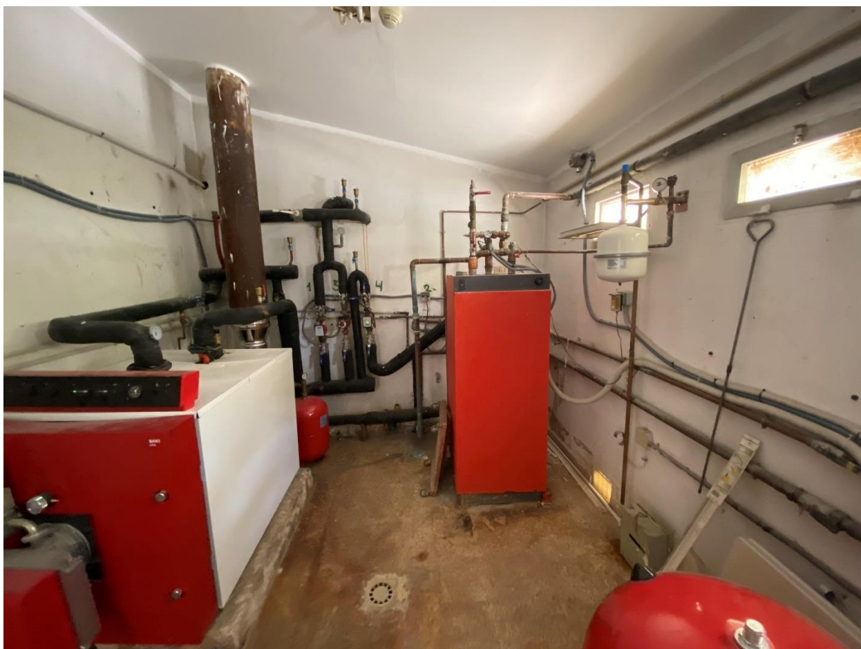
Detalle 1. Sala Maquinas
